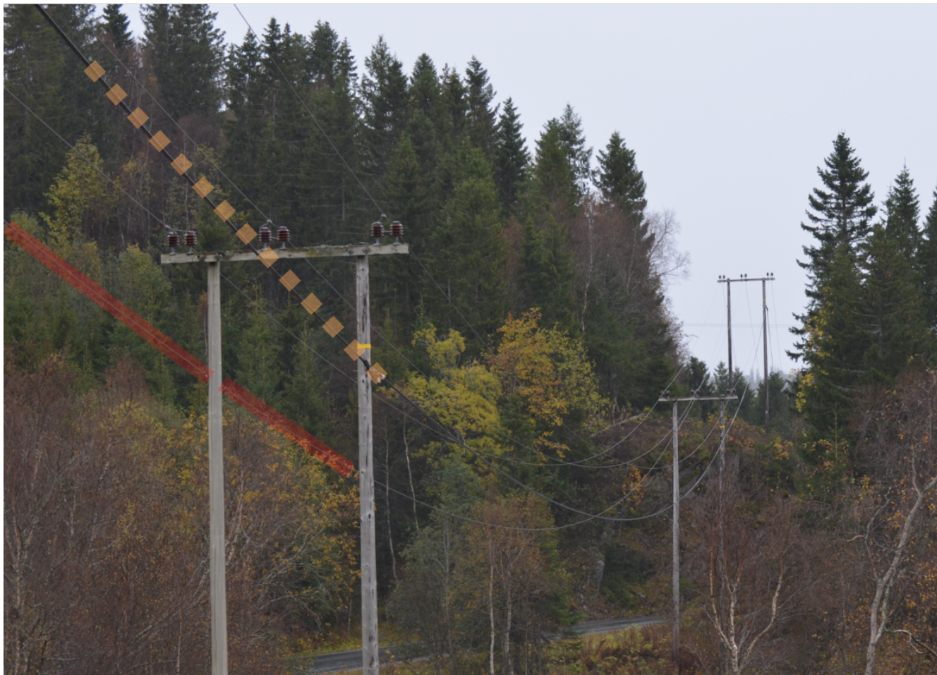
Figur 6. Eksempel på jordingsledning som henger under fasene (heltrukket strek). Til høyre er en kommunikasjonsline (stiplet strek).
