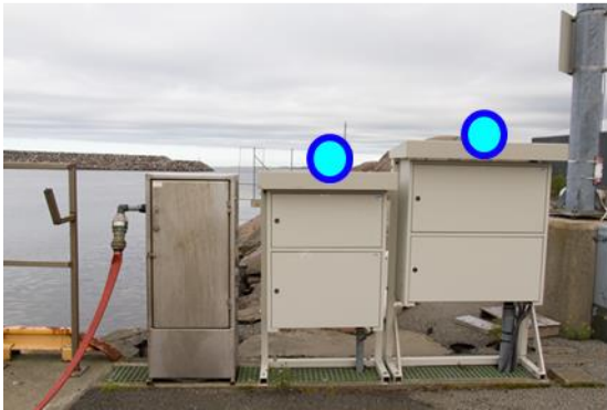
Bilde 15: ELkobling. De to øverste bildene er fra Kristiansand havn, det nederste fra Sirevåg. Registreres som enkeltpunkt på objektets midtpunkt i toppen av objektet, tilsvarende som for fordelingsskap i FKB. Høydereferanse: Topp. Norkart, 2020.
