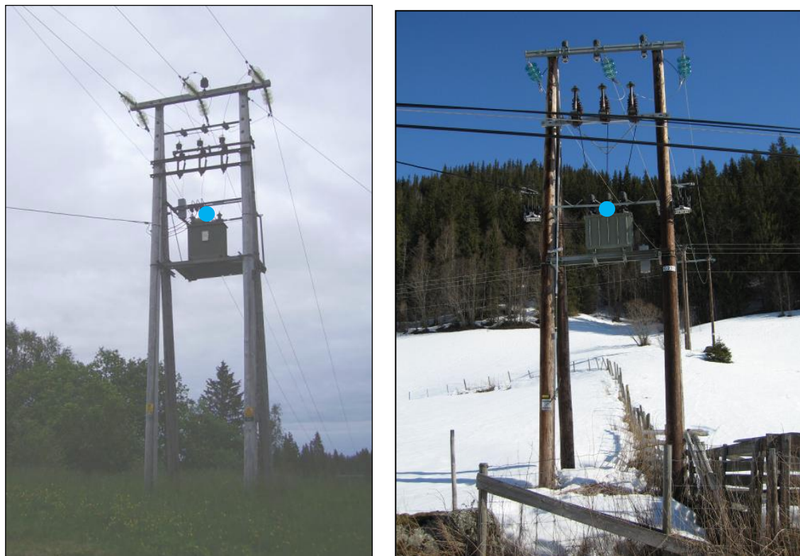
Figur 17: Eksempel på registrering av EL_Nettstasjon (Mastearrangement) (blå prikk)
