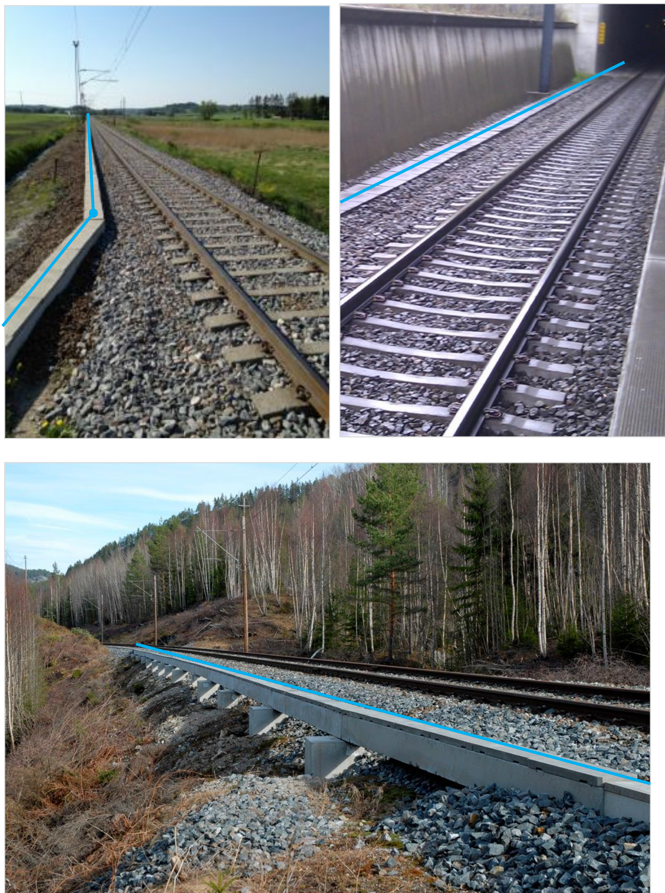
Figur 11: Eksempel på registrering av kabelkanal (foto: Jernbaneverket)
