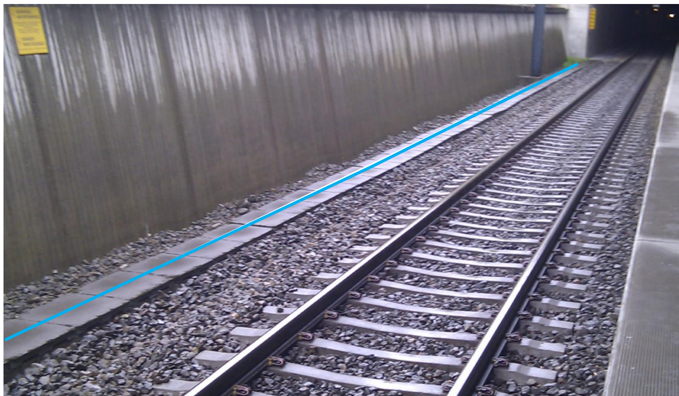
Figur 14: Eksempel på registrering av kabelkanal (foto: Jernbaneverket)
