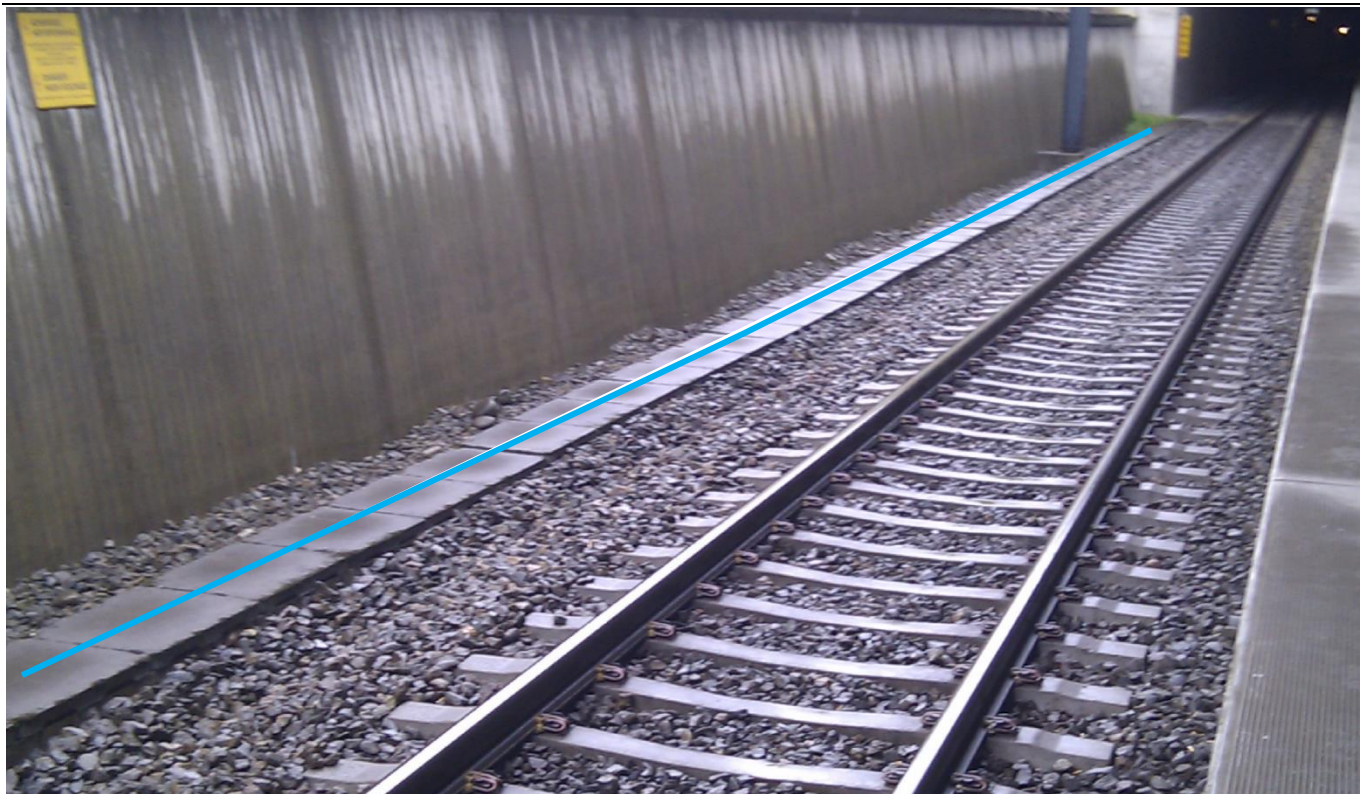
Figur 35: Eksempel på registrering av kabelkanal (foto: Bane NOR)
