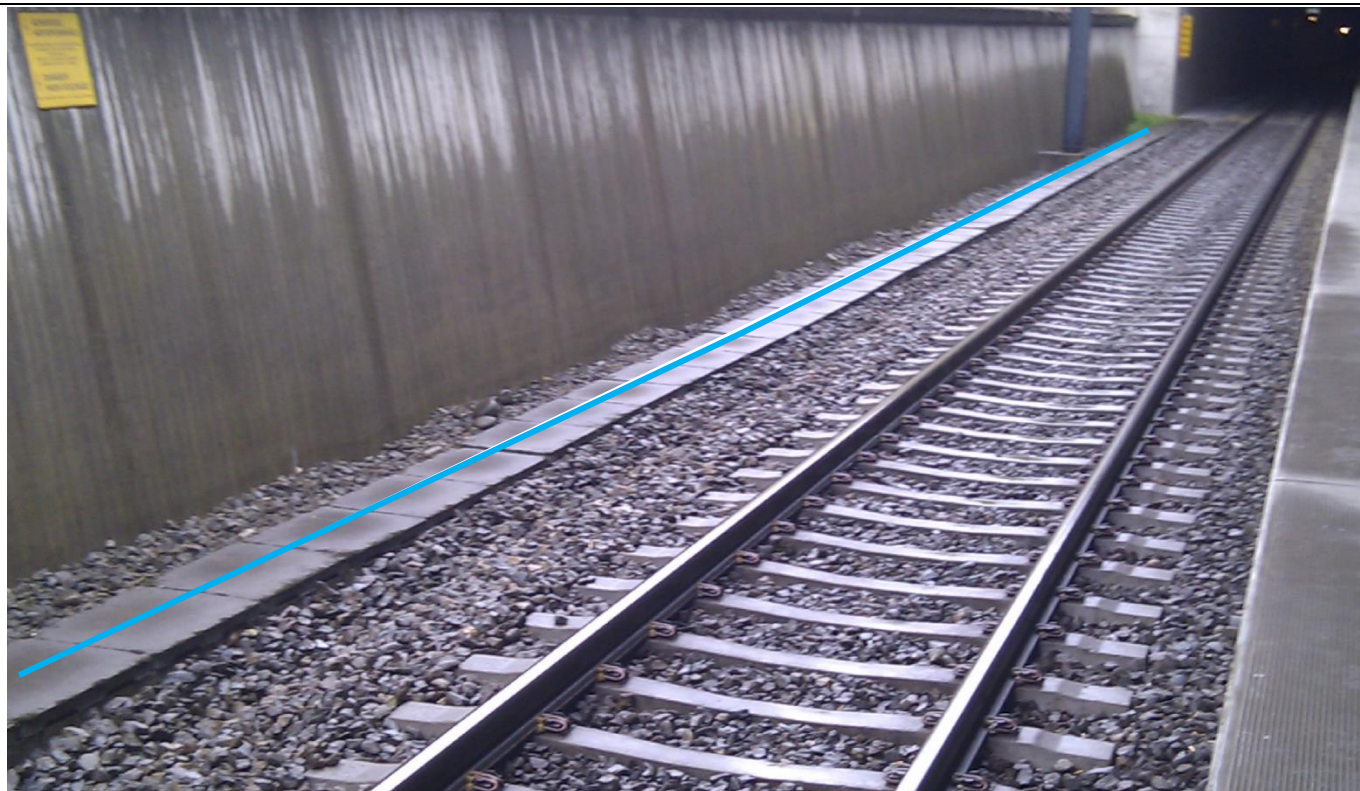
Figur 35: Eksempel på registrering av kabelkanal (foto: Jernbaneverket)
