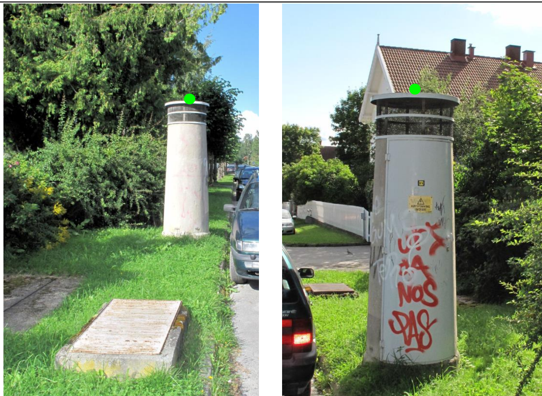
Figur 17: Eksempel på registrering av NettstasjonAdkomst (utlufting) (grønn prikk).
