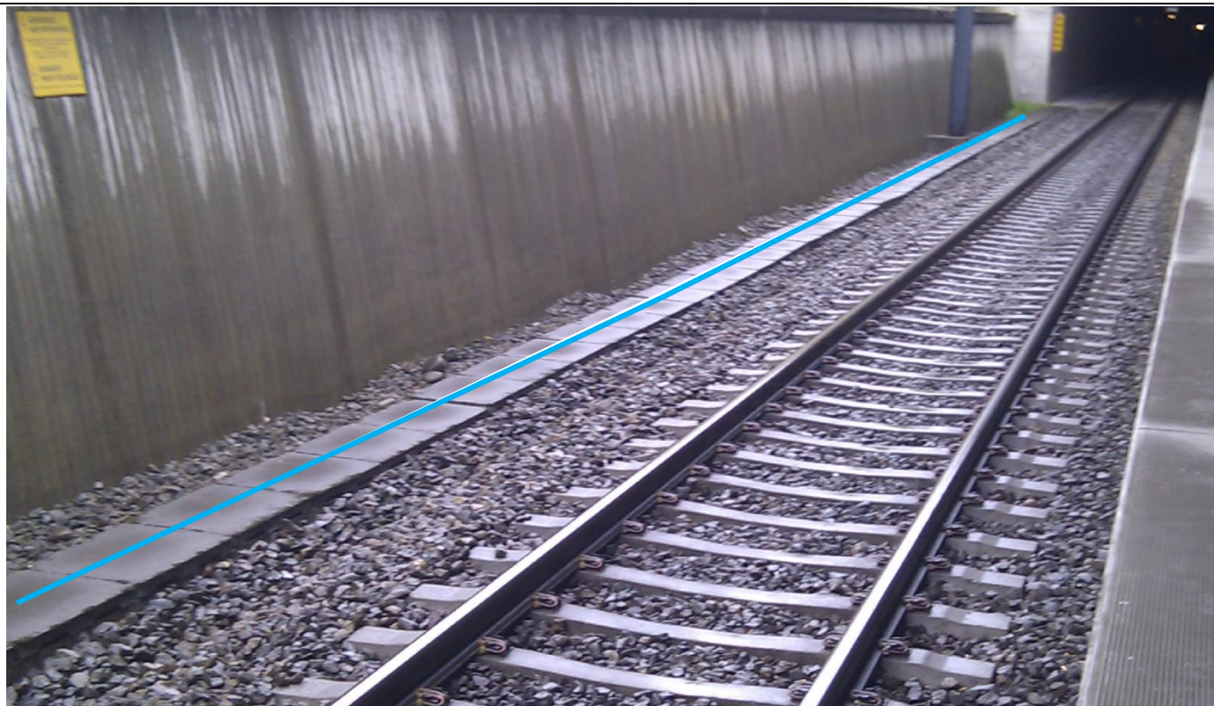
Figur 35: Eksempel på registrering av kabelkanal (foto: Jernbaneverket)
